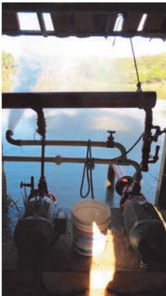
Foto 9 - sistema de aeração mecânica com 2 motores elétricos Aspecto da análise - Manejo da oxigenação
